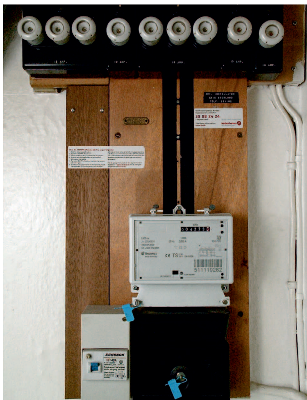
Typisk installation med gammel gruppetavle og ny elmåler og HFI-relæ. Sikringerne, der ses øverst i billedet, er af den gamle type, der skal skrues ud.
