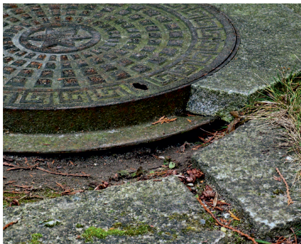
Slutter kloakdæksler ikke tæt til underlaget, kan det være tegn på rotter eller give anledning til problemer med dem.
